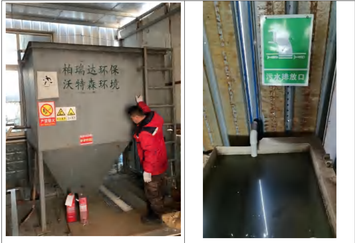
图4-2 污水处理设施
